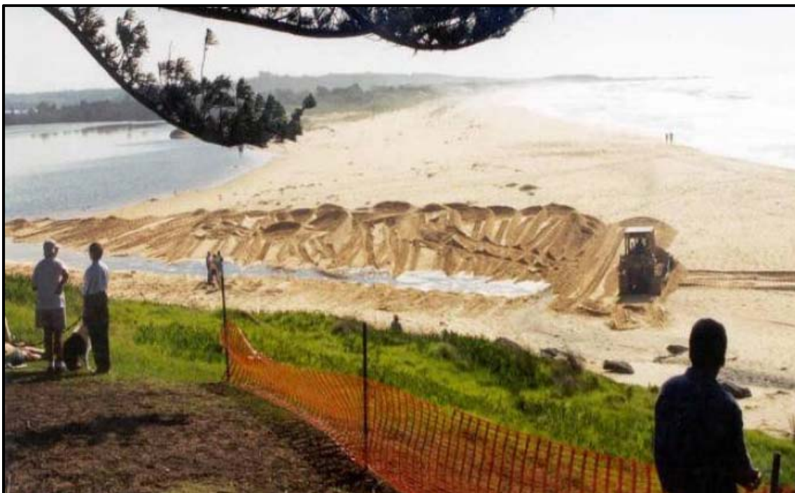
Figura 2.4. – Construção de um canal piloto no Lago Coila em Abril de 2002 (Haines, 2008).
