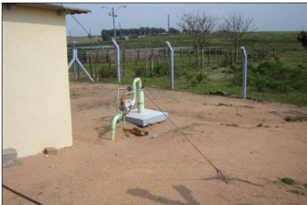
Figura 22 - Localização de um Poço Artesiano para Abastecimento do Município.
