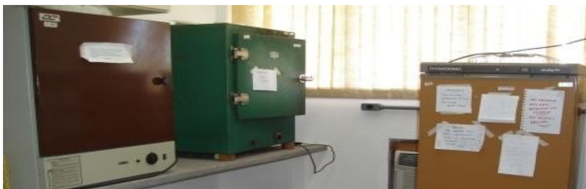
b. Equipamentos geradores de calor colocados em local arejado e em bancadas de pedra em conformidade com a legislação
