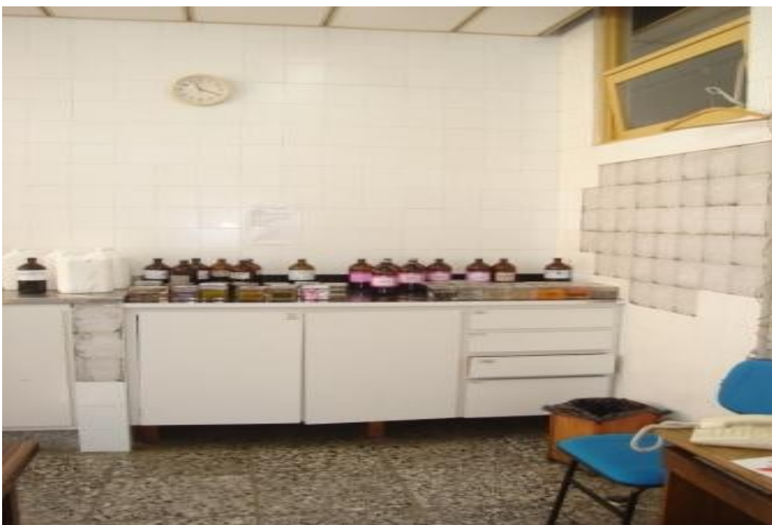
c. Falta de exaustão, azulejos e bancadas apropriadas (Reagentes para de lâminas patológicas).
