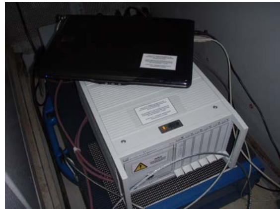
Figura 5.12 – Sistema de aquisição de dados e supervisão
