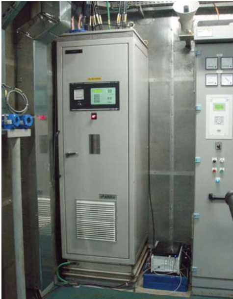
Figura 5.11 – Instalação do sistema de aquisição de dados na sala de painéis
