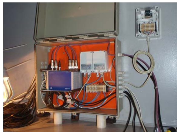
Figura 5.10 – Instalação dos amplificadores / condicionadores de sinais
