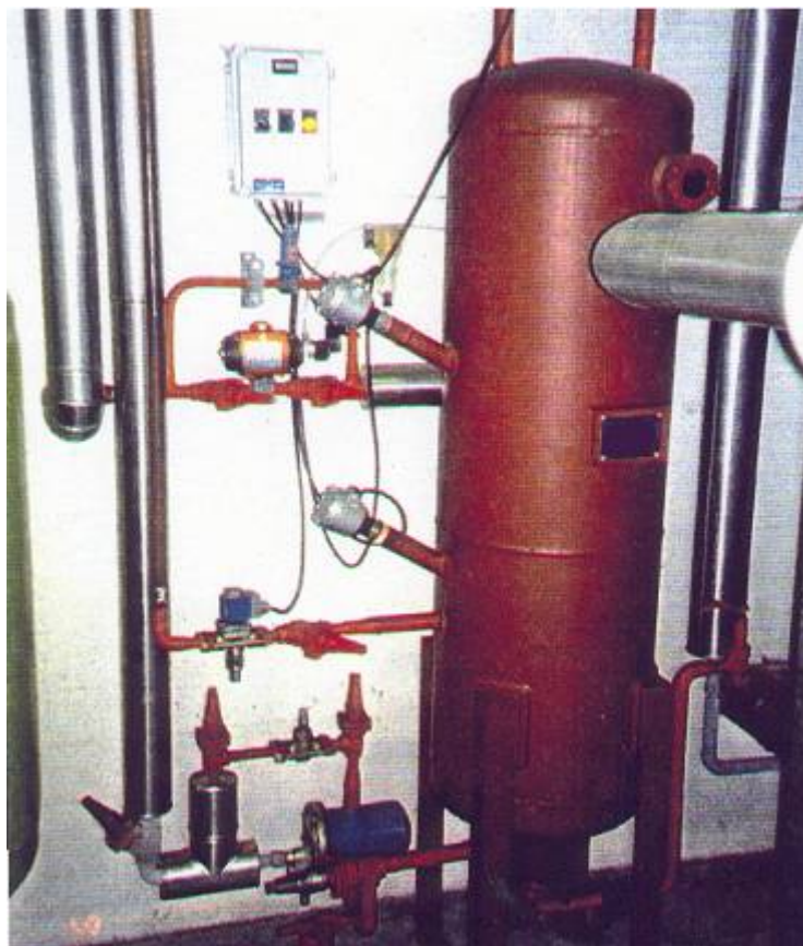
Figura 3.9 – Exemplo de um regenerador de R-717 com vapor quente automatizado
