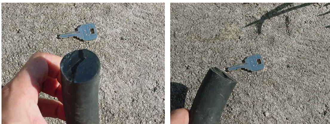
Fig A-9 - Foto do ponto de rompimento do cabo de borracha no segundo desgarre.
