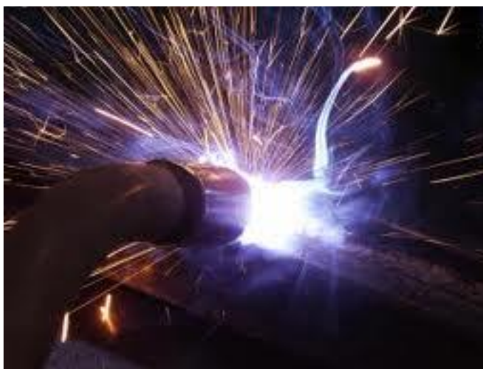
Figura 2. Abertura de arco elétrico para a atividade de solda
