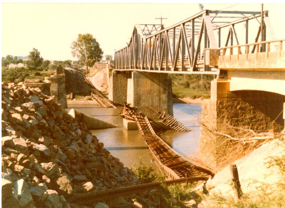
Imagem 19: Ponte do trem destruída (1983)
