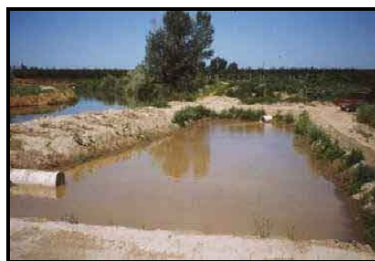
Figura 4. Bacia de sedimentação
